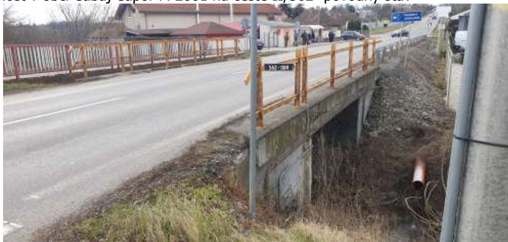
Most v obci Cabaj Čápor M 2801 na ceste II/562- pôvodný stav
