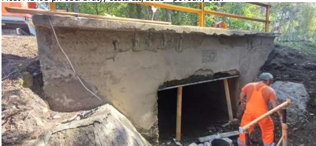
Most M1493 pri obci Bruty, cesta III/1521 - pôvodný stav
